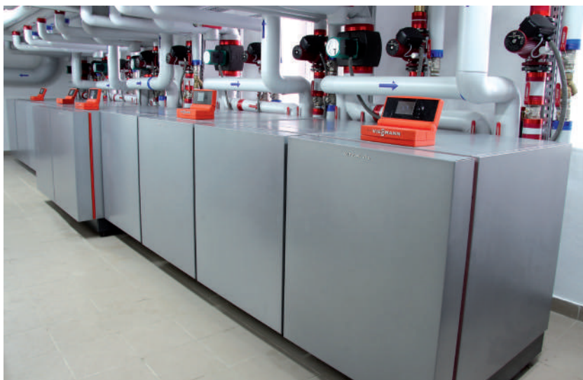
10 pomp ciepła solanka-woda Vitocal 300-G pracujących w układzie Master/Slave, o łącznej mocy 428 kW.
